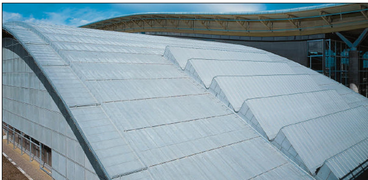
Abb. 1: Schneefangvorrichtungen über die gesamte Dachfläche verteilt (Quelle: Rheinzink)
