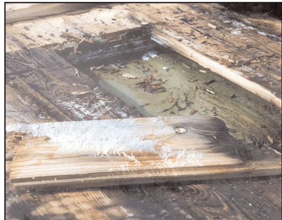
Bild 3: Eindringendes Wasser zerstört Holzschalung.
