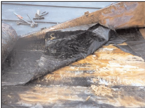
Bild 2: Gefällelose Doppelstehfalzeindeckung ermöglicht Wassereintritt.
