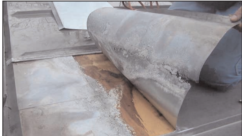
Bild 4: Kapillarität führt zum Eindringen von Regenwasser unter die Blecheindeckung.
