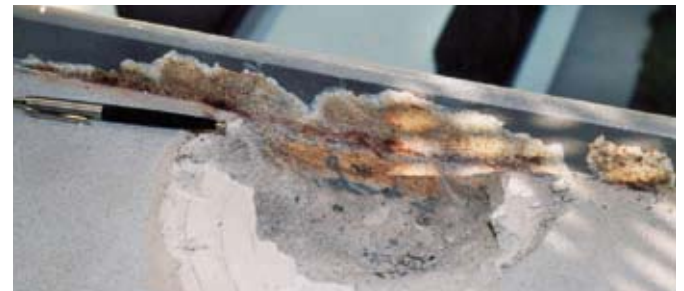
Abb. 7-9: Schadensbilder – Originalzustand, nach Entfernung der Bodenplatten, nach Entfernung des gesamten Bodenaufbaus bis OK Beton
