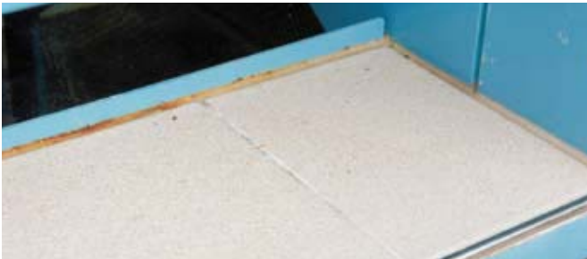
Abb 5: Betroffene Konstruktionselemente – Rahmenkonstruktion Balkon, Geländerpfosten Balkon und Trittwannen Aussentreppe
