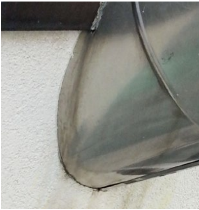
Bild 1 Schadensbild kein Abweisblech montiert
