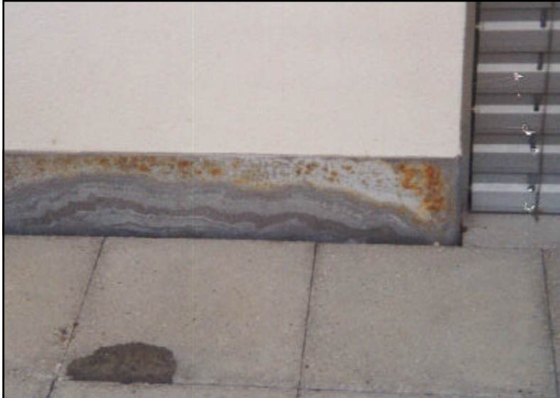
Abb. 5: Verfärbung von verzinnem Chromstahl durch Ausblühungen chloridhaltiger Zementplatten.
