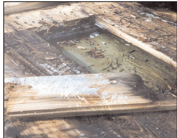
Bild 3: Eindringendes Wasser zerstört Holzschalung.
